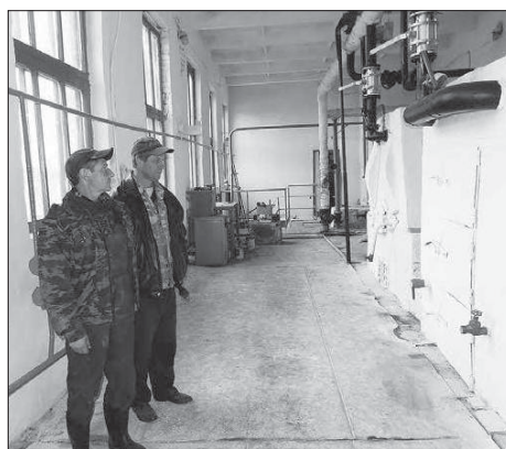
В котельной Жильско все готово к началу отопительного сезона
