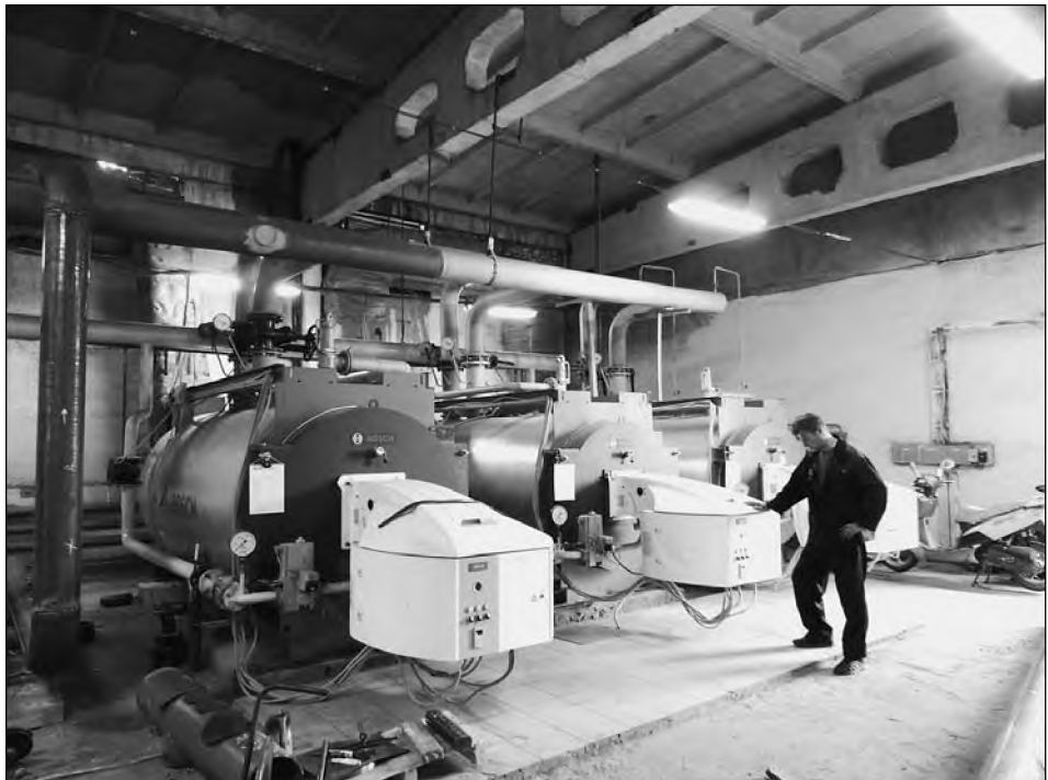
Новые котлы здесь были установлены ещё в прошлом году
