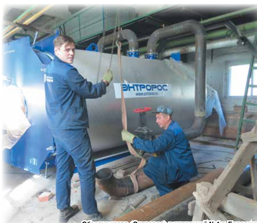
Обвязка котла «Энтропос» в котельной №1 г. Боровичи
