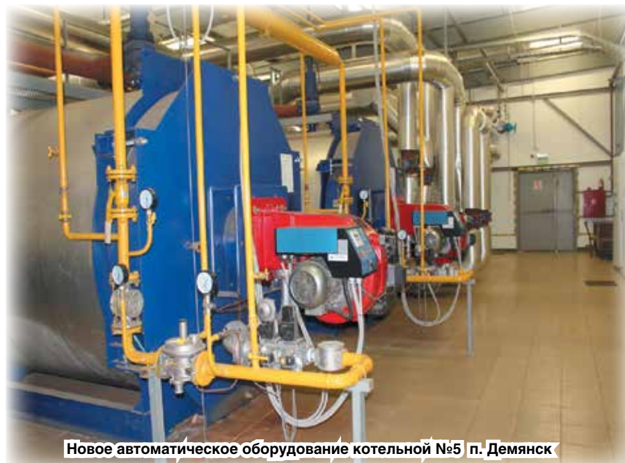
Новое автоматическое оборудование котельной №5 п. Демянск
