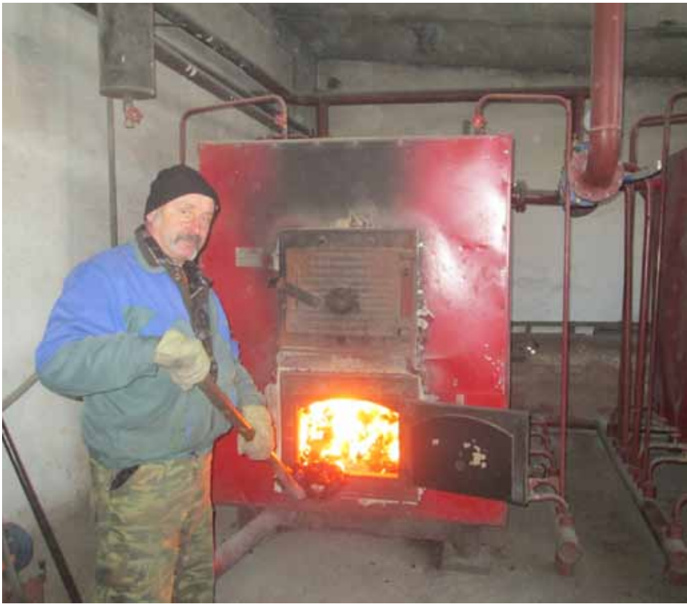
В котельных строго следят, чтобы любытинцам было тепло
