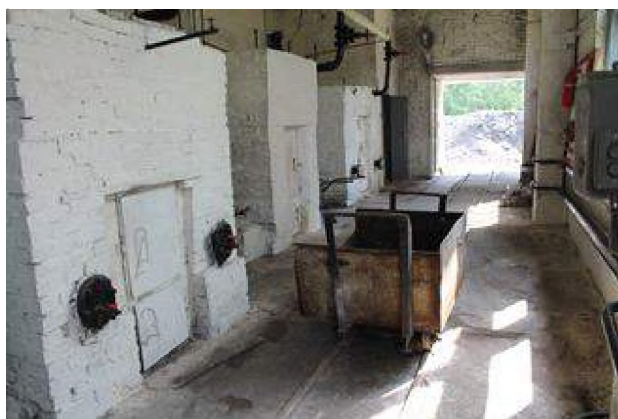
котельная №5 к зиме готова.
