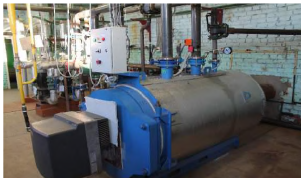
Новое оборудование в котельной №1
