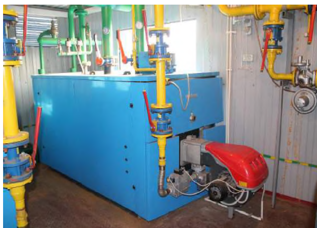
Оборудование блочно-модульной котельной №2
