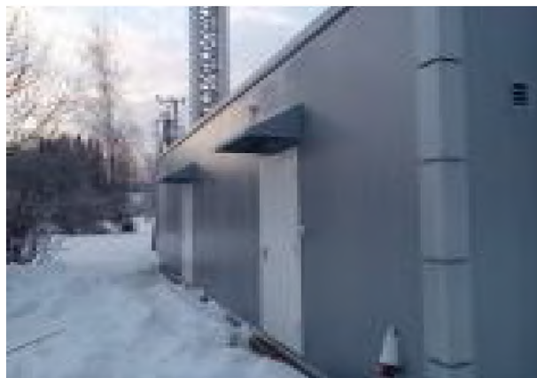
БМК мощностью 1,46 МВт в с. Зимогорье Валдайского района
