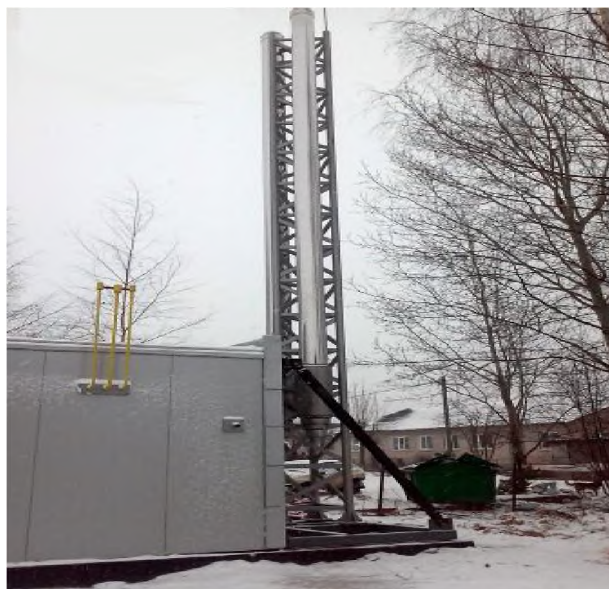
БМК мощностью 0,6 МВт в д. Большая Козона Старорусского района
