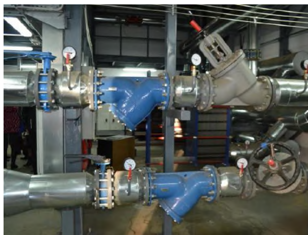
Оборудование котельной в Валдае
