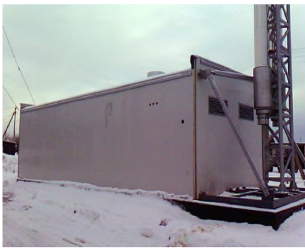
БМК мощностью 1,05 МВт в д. Передки Боровичского района
