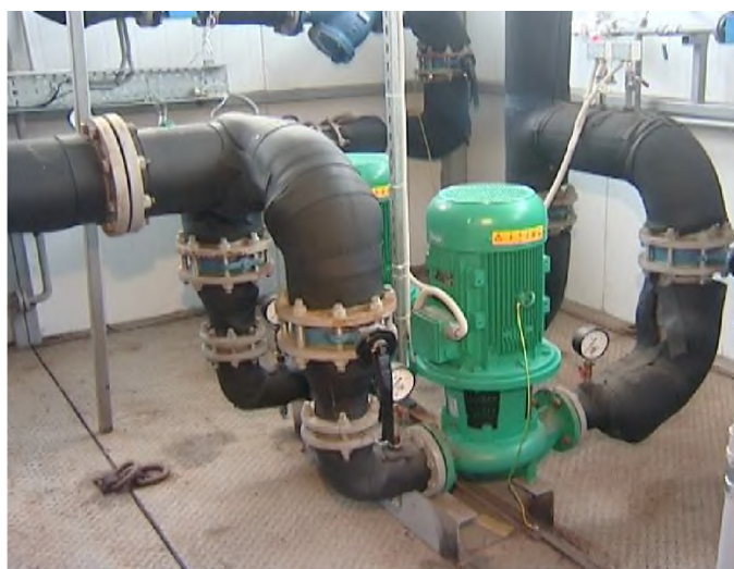
Оборудование БМК в Любытино
