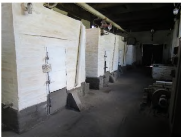
В котельной №2 чистота и порядок. Здесь все готово к новому отопительному сезону. Совсем скоро тепло от неё будут получать общеобразовательная школа, три больших многоквартирных дома, Школа искусств и Дом творчества с. Мошенское.
