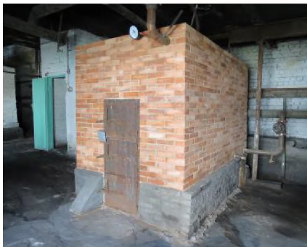
В котельной № 6 этим летом установили новый котел. Эта котельная - самая большая в с. Мошенское. Она даёт тепло потребителям центральной части села. Всего в зимний период здесь работают пять котлов.
