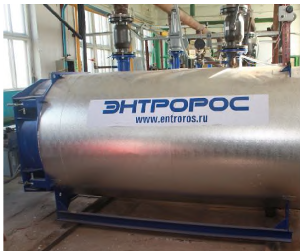
Новые котлы будут давать надежное тепло
