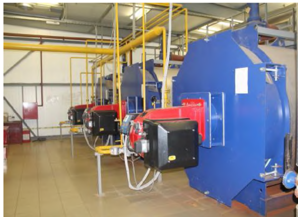
Новое оборудование работает исправно
