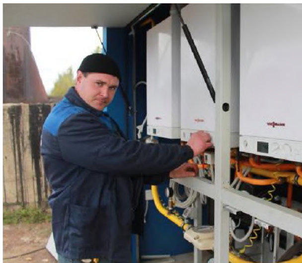
ТГГУ в с. Ямская Слобода. Слесарь по эксплуатации и ремонту газового оборудования проверяет работу котлов.
