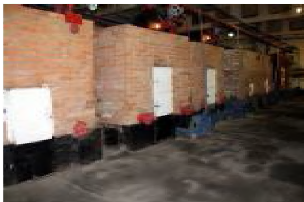
Котельная №3 – самая большая в Батецком районе, здесь 7 котлов. Пока на улице тепло, работают 4 котла.
