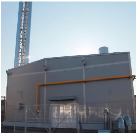
новая БМК в г. Валдае
