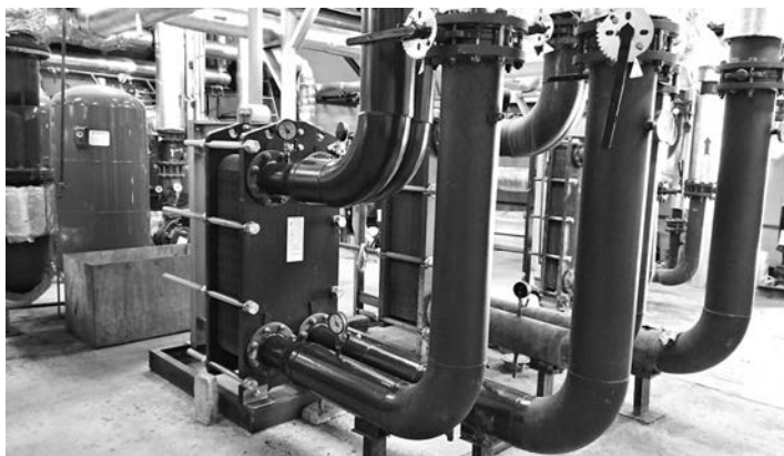
Новое оборудование (теплообменник) на блок-модульной котельной
