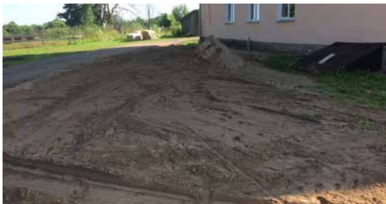
По завершении отопительного периода остатки дров складированы, а территории у котельных засыпаны песком
