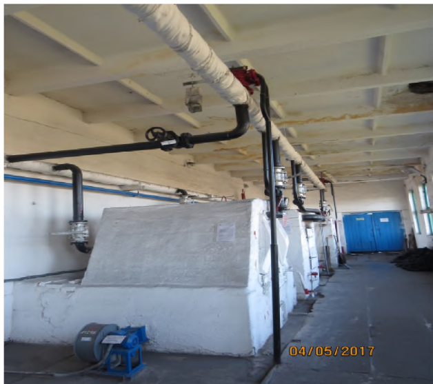
Котельная №14 в д. Жильско Солецкого района
