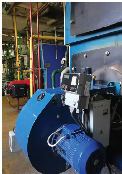
На фото: Котельная №9 в Боровичах
